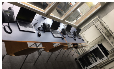
Abb. 15: Mobile-Rack aus dem Kommandoposten an einem ungeschützten Führungsstandort.
