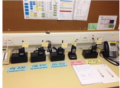
Abb. 7: Beispiel eines Telematik-Arbeitsplatzes am Führungsstandort.
