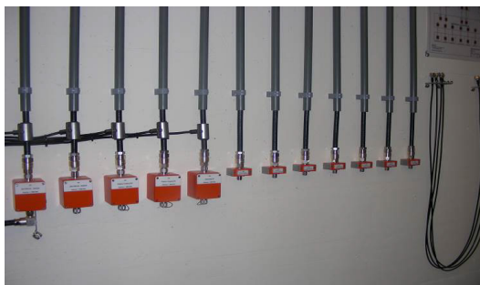
Abb. 34: Funkinstallationen im Telematikzentrum mit Verbindungskabel (rechts).
