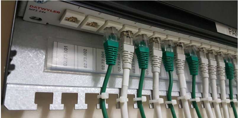
Abb 10: Verteiler mit den nummerierten Anschlüssen
