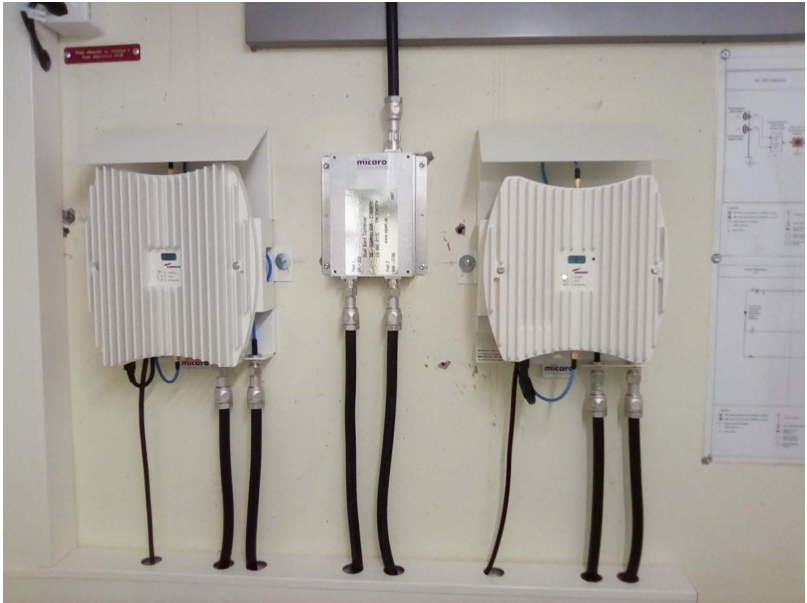
Abb 16: Beispiel eines aktiven Polycom-Breitbandrepeaters (links), eines Duplexers (Mitte) und eines Breitbandrepeaters für die Mobiltelefonie (rechts)
