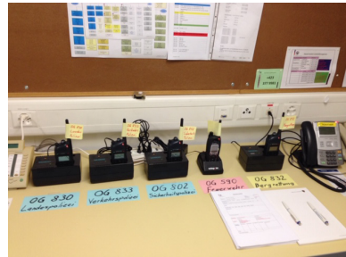
Abb. 7: Beispiel eines Telematik-Arbeitsplatzes am Führungsstandort.
