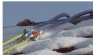
Verankerung am Dachfirst
